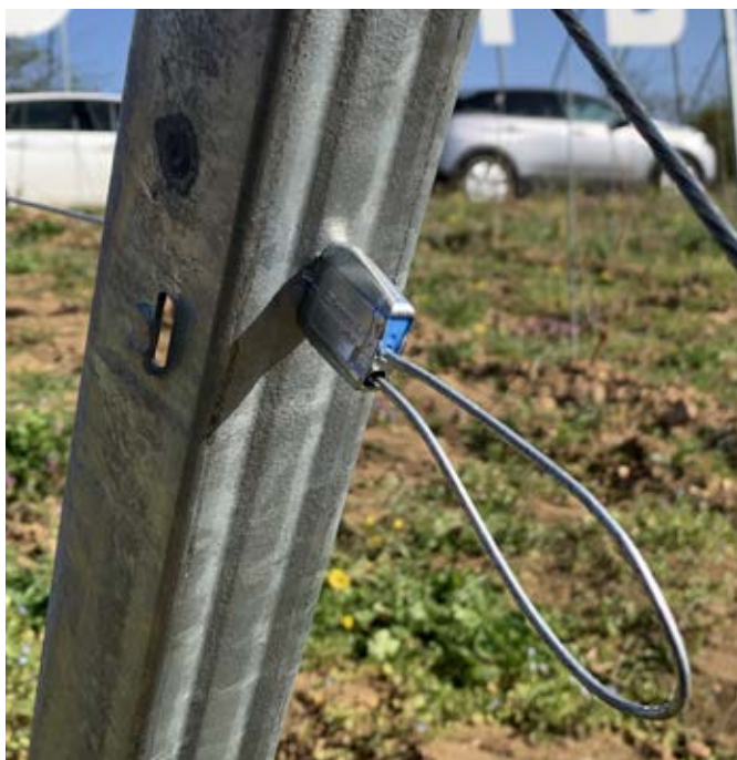
GP nr 1 installato su palo in metallo
